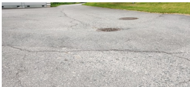
[2] Asfaltissa töyssy vedenohjausta varten
